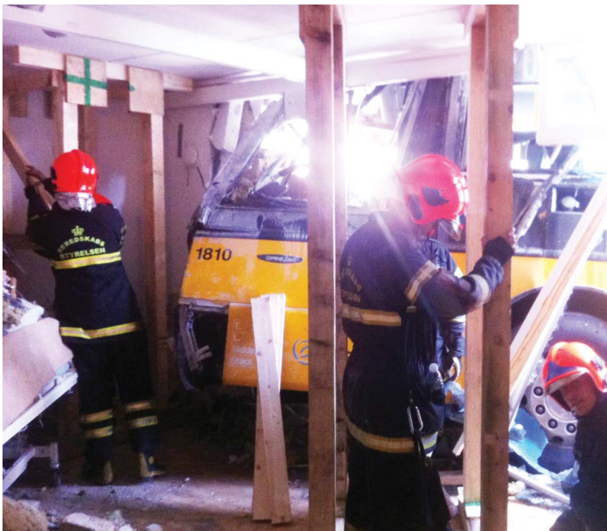
Beredskabsstyrelsen afstiver bygning i Ikast, efter at en bus er kørt ind i bygningen.
