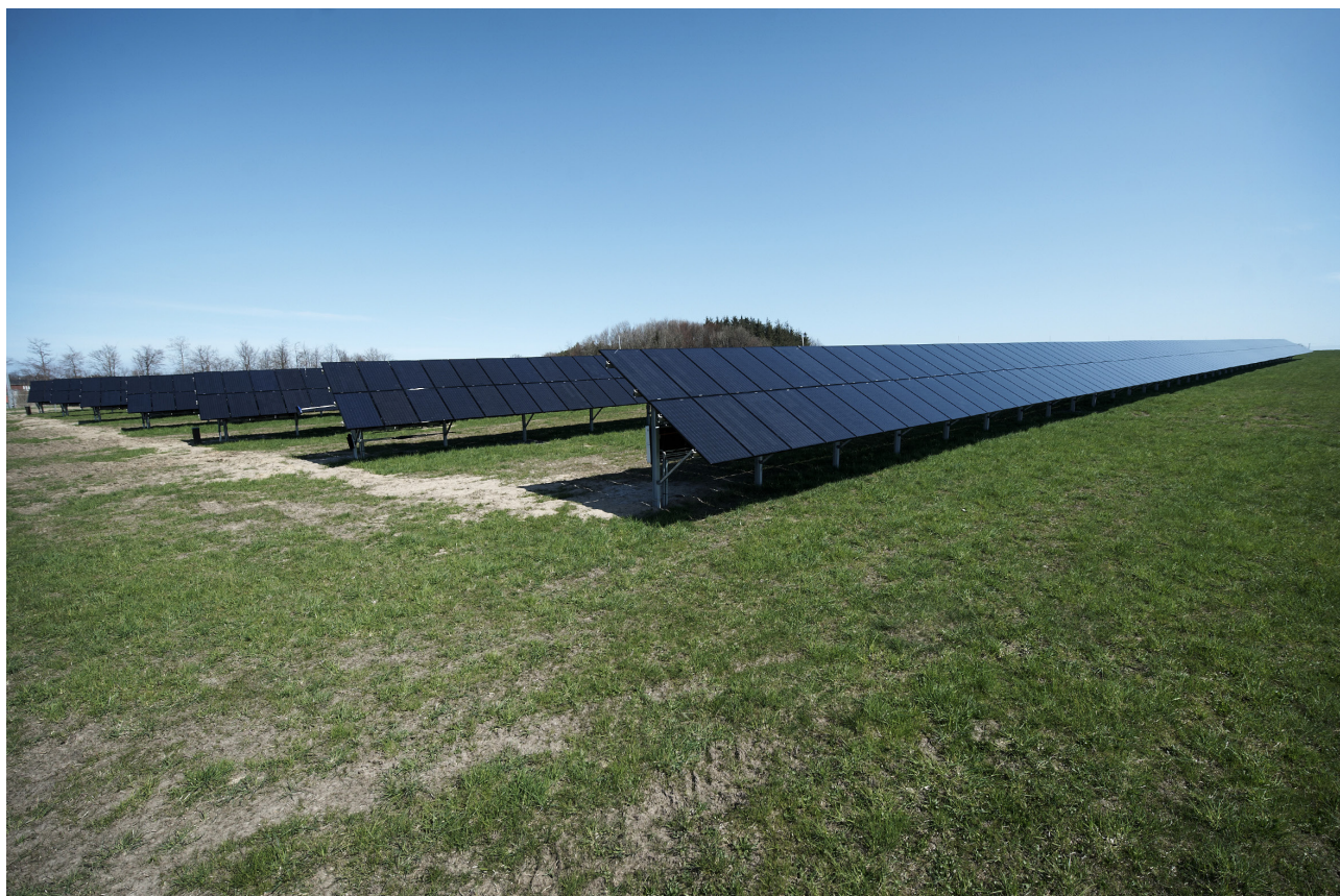
Forsvarets Bygnings- og Etablisementstjeneste har opstillet solcelleanlæg på i alt 19.177 m 2 . Det fulde mål om opstilling af solcelleanlæg på i alt 20.000 m 2 , som egentlig først skal indfries i 2015, er således næsten opfyldt. Foto: Forsvarets Bygnings- og Etablisementstjeneste.
